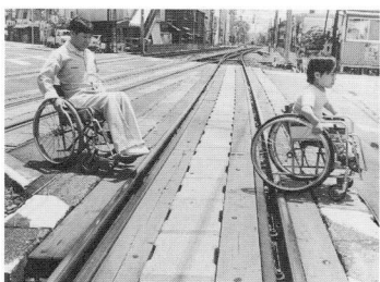
このデコボコ踏切もいまは改修されている
